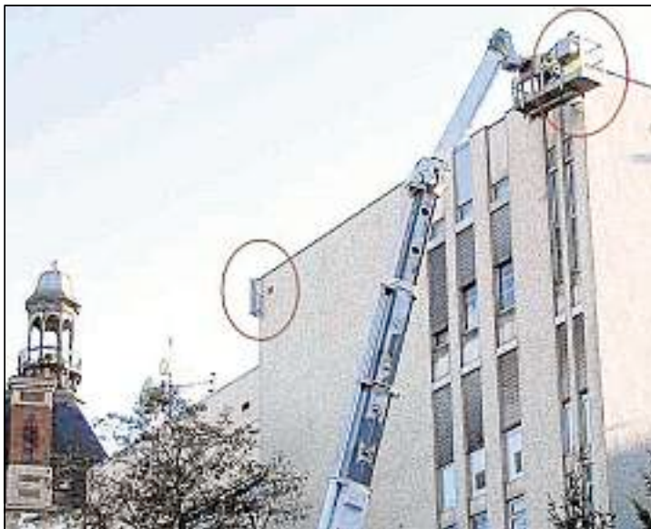
Les antennes ont pris place sur le toit du central France Télécom.
